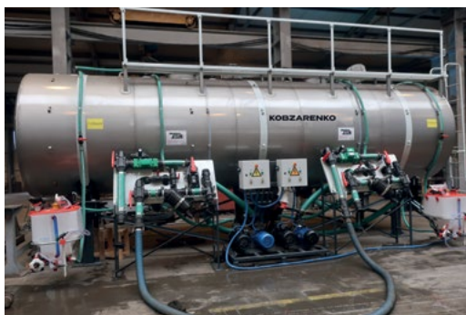
Stacjonarny węzeł napełniania RZS-20 z dwoma niezależnymi komorami
